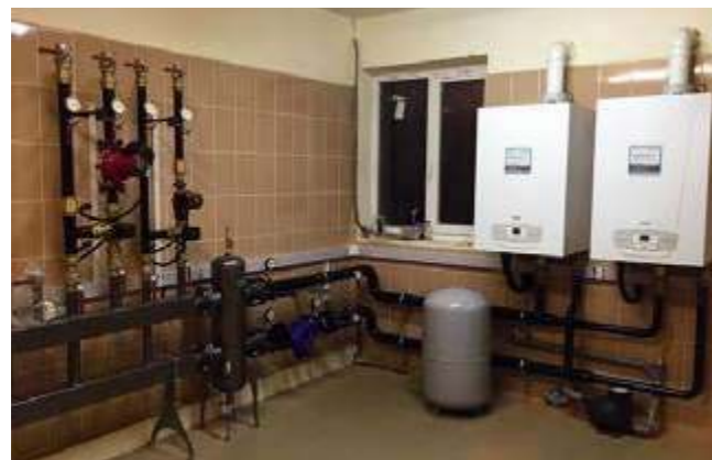
Автосервис, г. Москва Общая мощность котельной - 300 кВт
