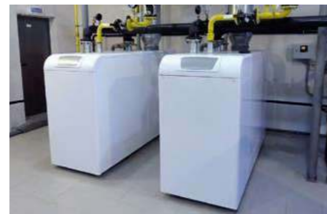
ТЦ «Крона», г. Чебоксары Общая мощность котельной - 1 МВт
