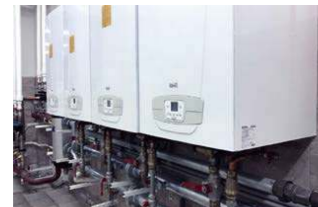
Общежитие, г. Усть-Луга Общая мощность котельной - 300 кВт
