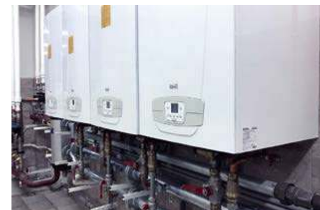
Общежитие, г. Усть-Луга Общая мощность котельной - 300 кВт
