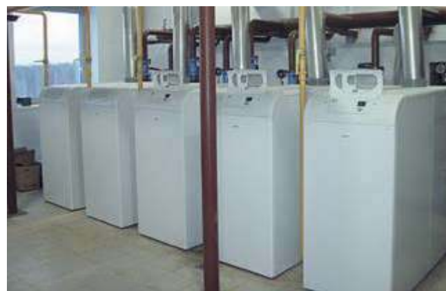
Кинотеатр, г. Йошка-Ола Общая мощность - 1,6 МВт
