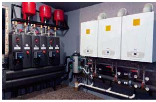
Гостиничный комплекс, г. Архыз Общая мощность котельной - 300 кВт
