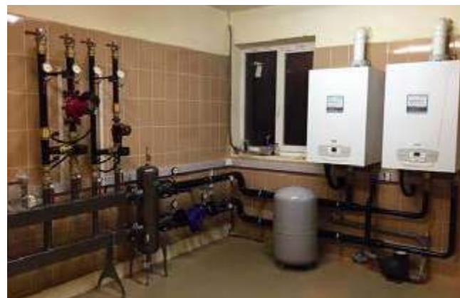
Автосервис, г. Москва Общая мощность котельной - 300 кВт
