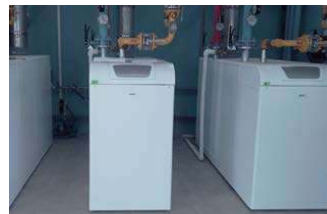
Жилой дом, г. Сочи Общая мощность котельной - 1,5 МВт
