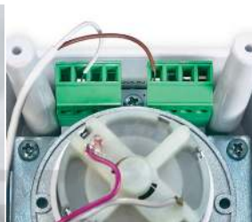
Фото 11. Подключение датчика к электроприводу
