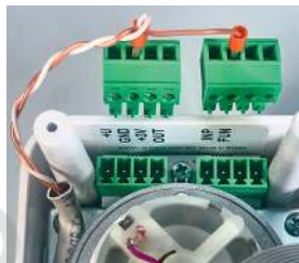
Фото 18. Подключение проводного выключателя к электроприводу
